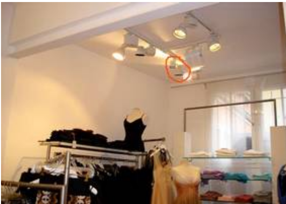
Das Bild zeigt ein typisches Beleuchtungssystem, welches oft eingesetzt wird. Unser Kameragehäuse kann an dieses Schienensystem angebracht werden. Die Kamera ist in das Lampengehäuse eingebaut. Die Frontseite ist mit einem Spiegelglas abgedeckt, sodaß keine Kamera sichtbar ist. Bei diesem Modell kann die Blickrichtung noch unabhängig von der Montagerichtung es Scheinwerfers eingestellt werden.
